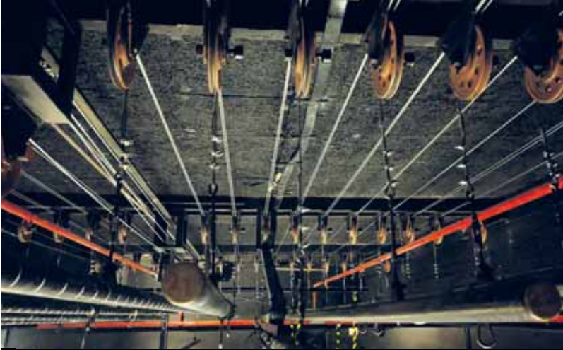
Detail ručních tahů na zadním jevišti. Od nové sezóny budou všechny tahy již motorové
